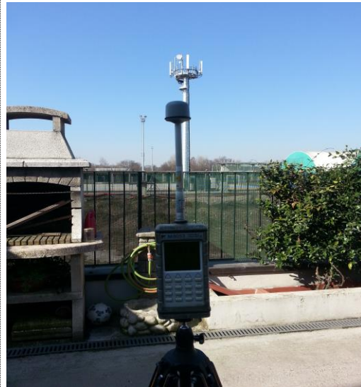
Foto 2 - Misura M 1 fronte antenna, lato ovest abitazione privata di Via Antonio Meucci
