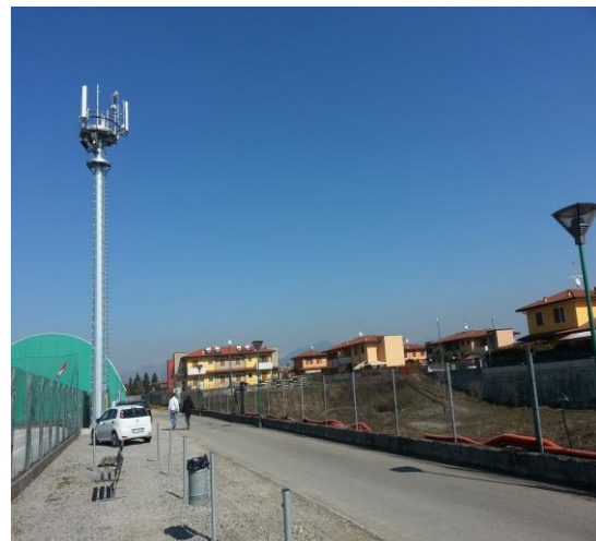
Foto 6 - Posizione installazione SRB rispetto alle residenze più vicine di Via Antonio Meucci
